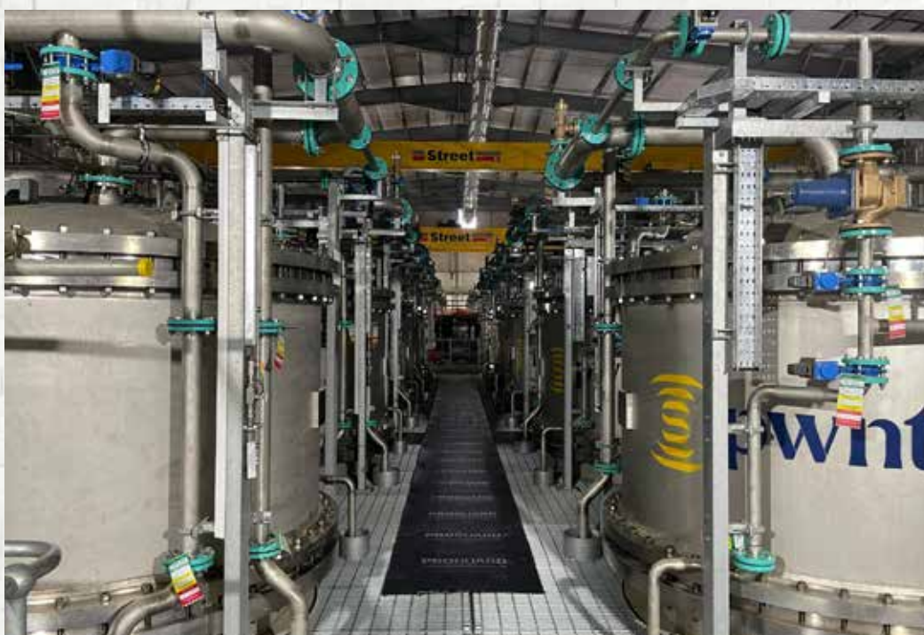
Installations CeraMac® à Hampton Loade WTW, Royaume-Uni (source: PWNT)
